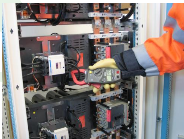
Mesure de l'intensité réelle d'une batterie de compensation.
